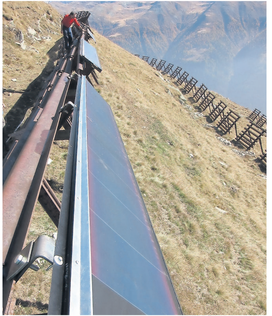
In Reih und Glied. Die Solarpanels entlang einer Lawinerverbauung im Skigebiet von Bellwald.
