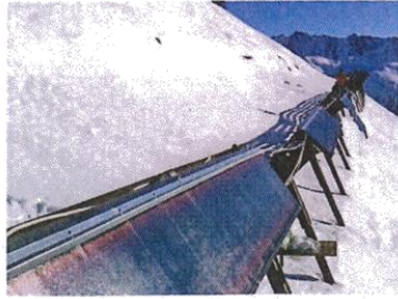
Blick auf die Solarpanels im Winter. Vielleicht wird im nächsten Herbst bereits Energie ins Netz eingespeist.
