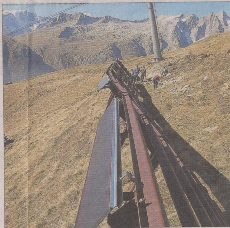
Nebst den bereits von Studenten montierten kleinen Panels will die EnAlpin 2011 auf den Lawinenverbauungen von Bellwald eine grössere Solar-Pilotanlage bauen.
